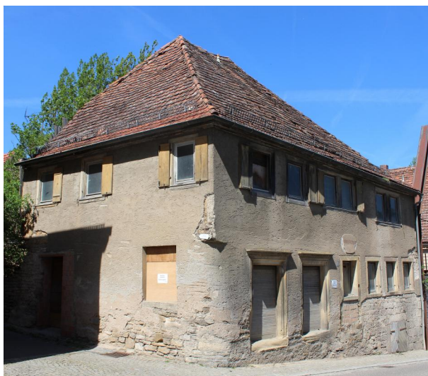
Aub, Hauptstraße 21, einsturzgefährdete ehem. "Alte Synagoge" (Aufnahme 2022). Copyright Haus der Bayerischen Geschichte / Eva Maria Kraiss
